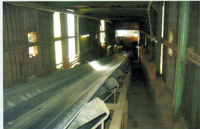
Abb. 2 Für den Kraftwerksbetreiber ist nach dem Outsourcing des kompletten Aschetransports lediglich von Bedeutung, „dass alles reibungslos läuft“ Fotos: RWE
