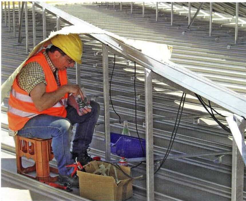
Schon spürt man die Kraft der Sonne: Montage von Steckern zur Verkabelung der Module auf dem 70 °C heißem Blechdach
